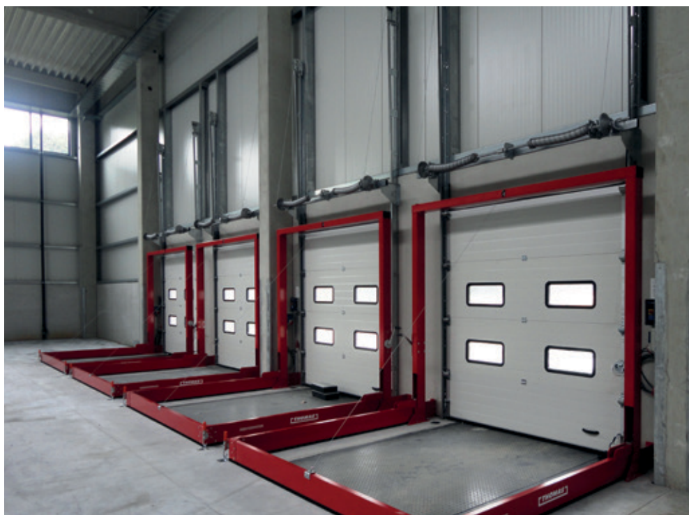
Manuelle Löschwasserbarrieren bei Laderampen
